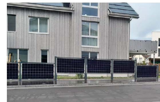
Premium Solarzaun 150 einbetoniert
